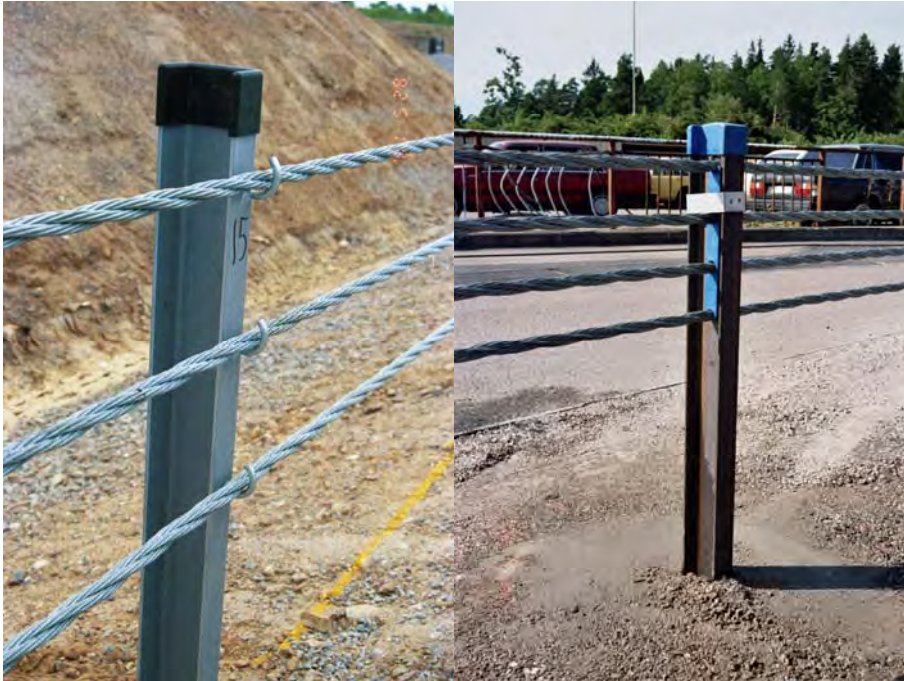
Figur 1 Till vänster vajerräcke monterat som slänträcke från Gunnebo Protection och till höger: räcke monterat som mitträcke från Blue System.
