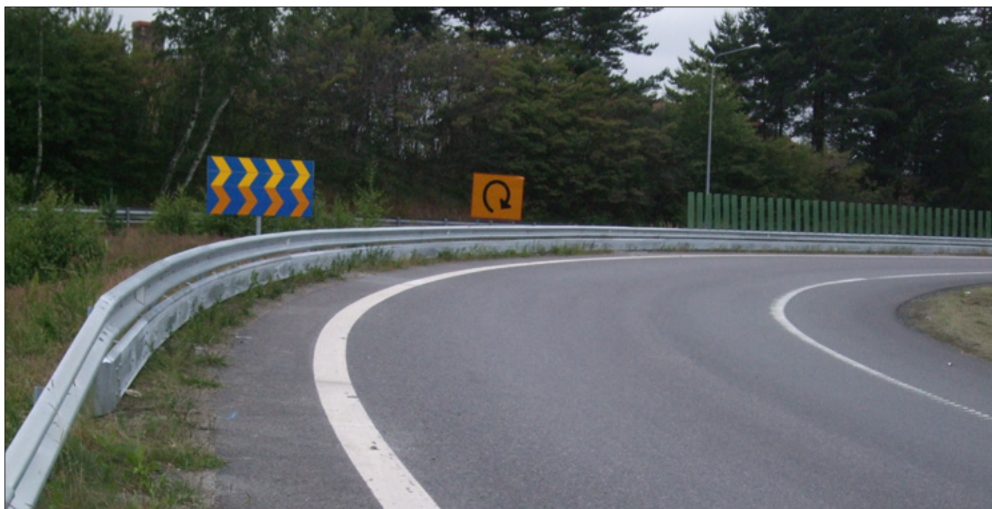
Underglidningsskydd på räcke och varningsskylt för nypande kurva i Trafikplats Ljungarum utanför Jönköping.
