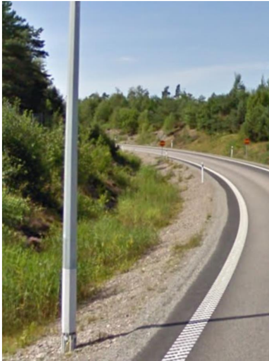
Eftergivlig stolpe med högt fundament som fordon riskerar att fastna på.
