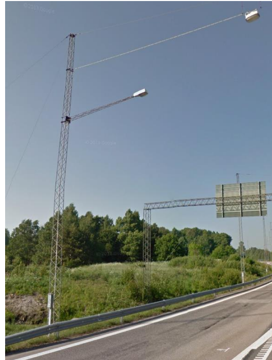
Eftergivlig fackverksstolpe med staglinor och hängkblar som förhindrar stolpens tilltänkta funktion vid påkörning
