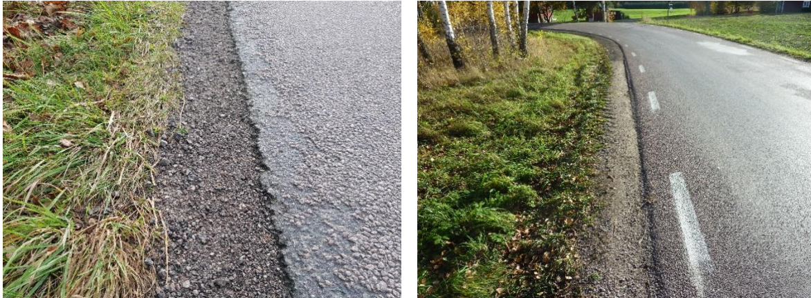
Figur 14. Stödremsa av asfaltsgranulat. Till höger tydlig gräns för komplettering i utgången av kurva.
