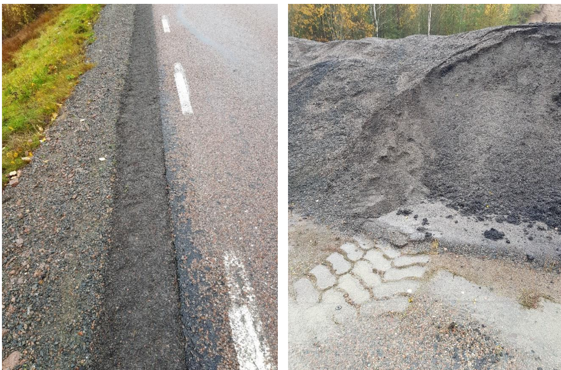
Figur 40. Till vänster bred grusskuldra med smalare bitumenhaltig stödremsa. Till höger: Upplagshög av bitumenhaltigt 0/8 mm grus.
