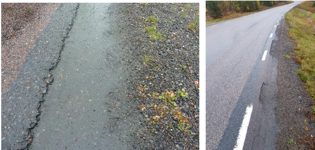
Figur 13. Försegling av stödremsa med bitumen. Till vänster asfaltsliknande yta, till höger vissa typiska skador men med bibehållen funktion.
