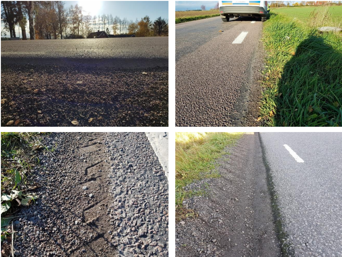
Figur 44. Uppe till vänster gruskorn på vägytan samt stor nivåskillnad mellan vägyta och stödremsa. Uppe till höger avsaknad av synlig stödremsa. Nere till vänster stödremsa i nivå med beläggning med traktorspår. Nere till höger nivåskillnad mellan stödremsa med traktorspår.
