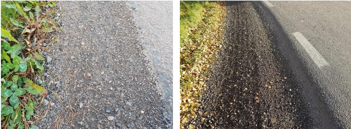
Figur 43. Till vänster något grusig stödremsa av asfaltsgranulat. Till höger: bortkörd, ned- och uttryckt stödremsa, observera höjdskillnad vid beläggningskanten.
