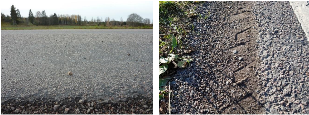
Figur 15. Till vänster, i måttlig omfattning, löst grus på vägbanan från asfaltsgranulat. Till höger traktorspår på stödremsa.
